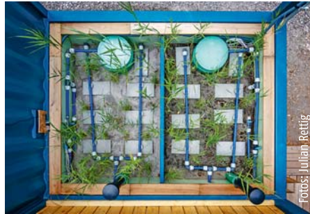
Die Pflanzenkläranlage arbeitet im Container.
